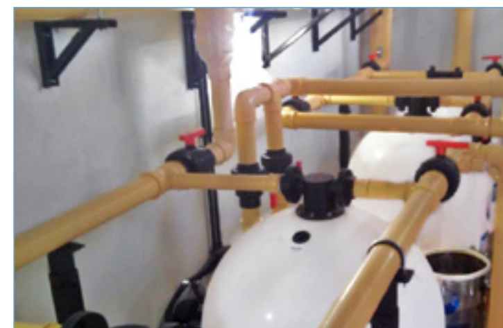
Unidade SESI - Ribeirão Preto - SP (Filtros com meia válvula de ferro fundido)
